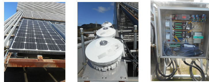
図：鹿児島県工業技術センターに設置している太陽電池モジュール、気象測器、データ収集システムの外観（これらの機器類はいずれも新潟大学の資産である）。
