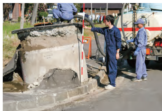
液状化によるマンホールの浮き上り(中越地震)
