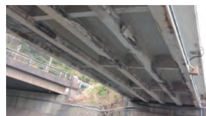
塩害によってひび割れが発生した橋梁
